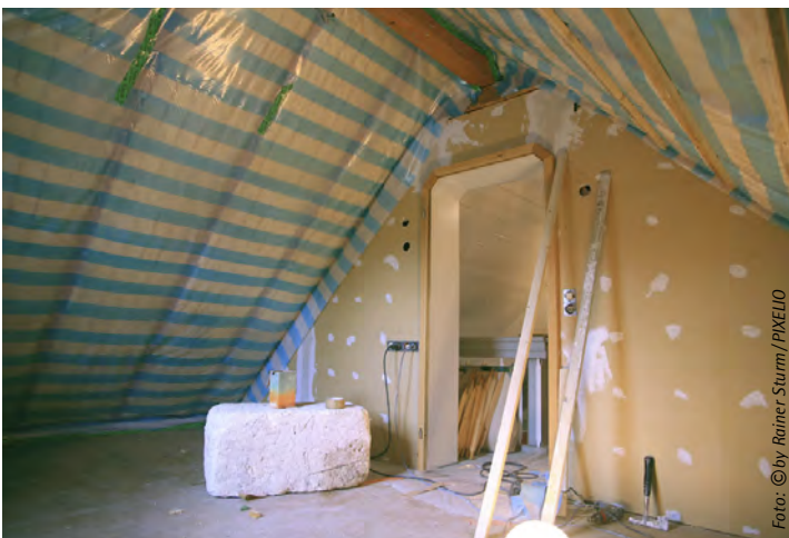
Im vorliegenden Fall wurden Mängel an der Dampfsperre festgestellt, jedoch ohne dass es bereits zu weiteren Schäden gekommen war.
