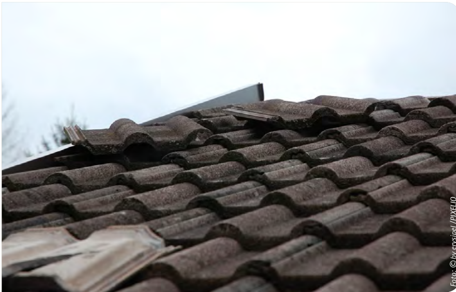
Dachschaden nach einem Sturm
